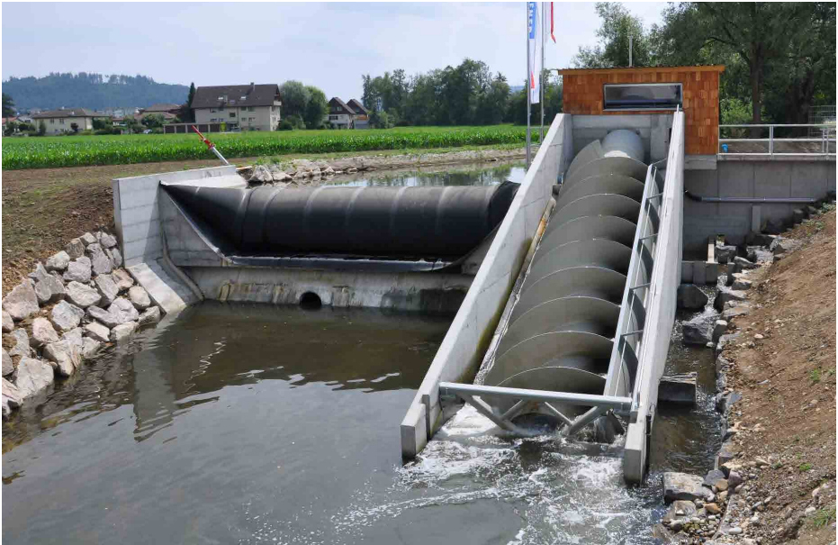
Abb. 1 Das Kleinwasserkraftwerk Hirschthal ist bereits in Betrieb. Die hier gemachten Erfahrungen sollen bei den Suhre-Projekten einfließen.
