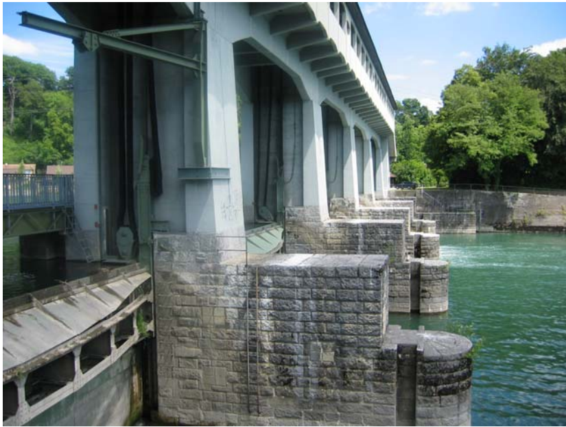
Photo 1: les prévisions des débits sont utilisées pour planifier l'exploitation des centrales hydroélectriques, surtout en cas de crues. Le barrage de Winznau régule l'apport de l'Aar dans le bief amont de la centrale au fil de l'eau de Gösgen. (Photo: Bruno Schädler)
