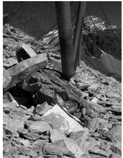
Instabil: Unterspültes Fundament und ausgekugelte Pendelstütze eines Schneenetzes im kriechenden Permafrost. (Bild: SLF)
