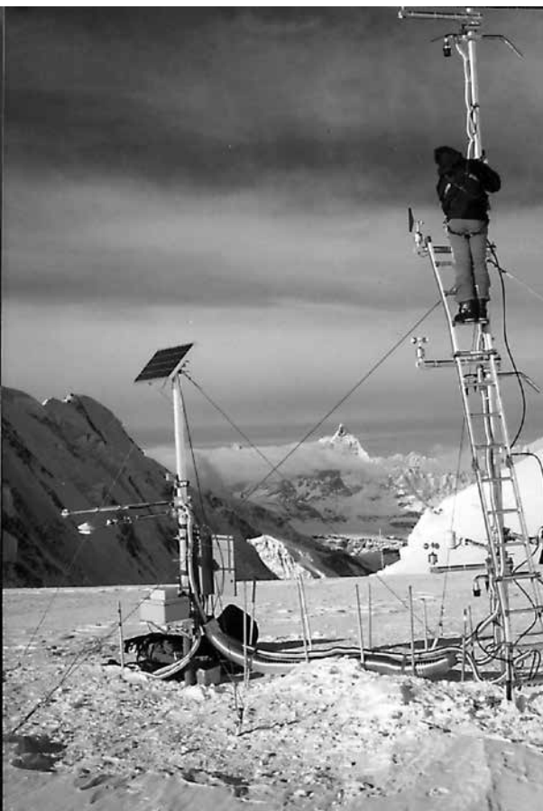
Installation einer Klimastation auf dem Seserjoch Installation d'une station climatique sur le Seserjoch (Bild/Photo: Stephan Suter)
