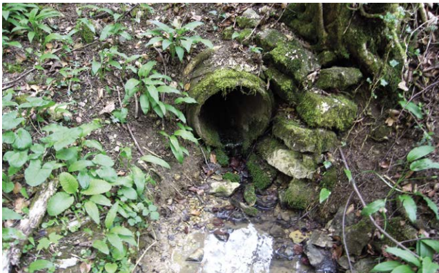
Abbildung 3.2 Stark geschädigter Quell-Lebensraum: Verrohrter Grundwasseraustritt
